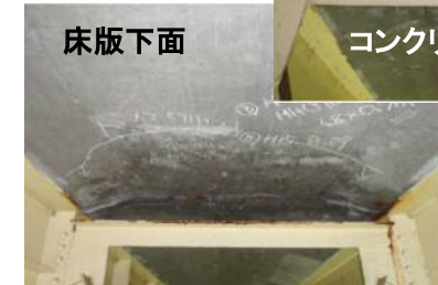
床版下面の漏水による塩害損傷状況
