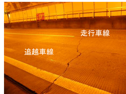
路面隆起によるクラック
